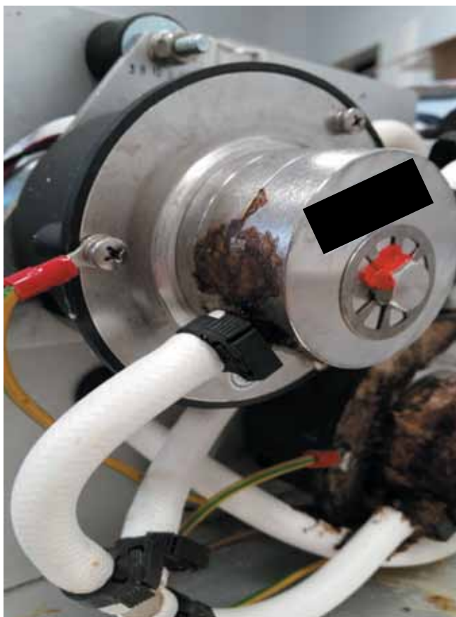
Рис. Коррозия насоса концентрата под воздействием соляной кислоты
